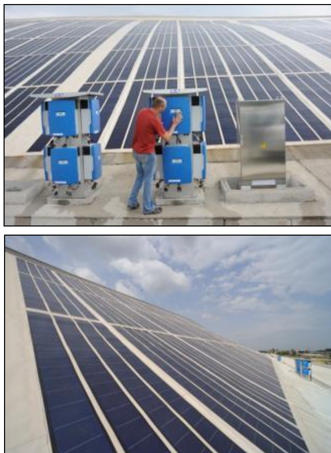
Abbildung 5-6: String-Wechselrichter sind im Photovoltaik-System der Deponie Malagrotta in gleichmäßigen Abständen angeordnet
