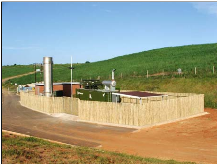
Bild 1 mustergültiger Deponiebetrieb – Umwandlung von Deponiegas in Elektrizität [4]
