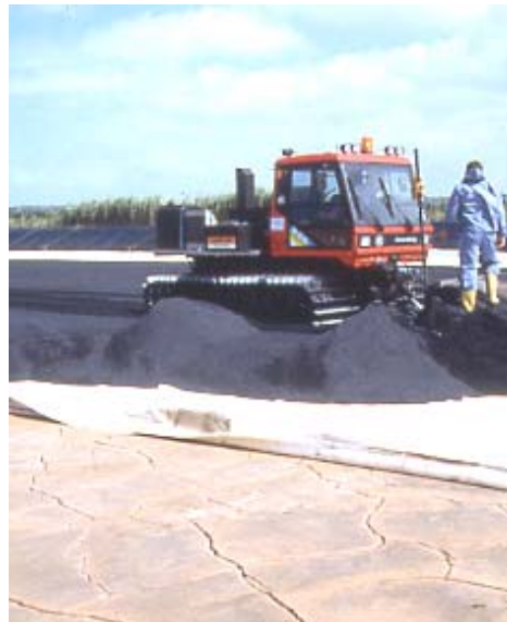
Bild 8: Galing I: Verteilung der ersten Bodenlage auf dem Comtrac®; die Trockenkruste mit Rissen täuscht Stabilität nur vor (Foto HUESKER)
