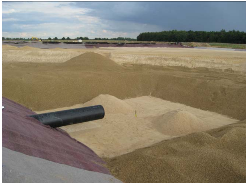
Abb. 4: Zufluss zum Bodenfilter
