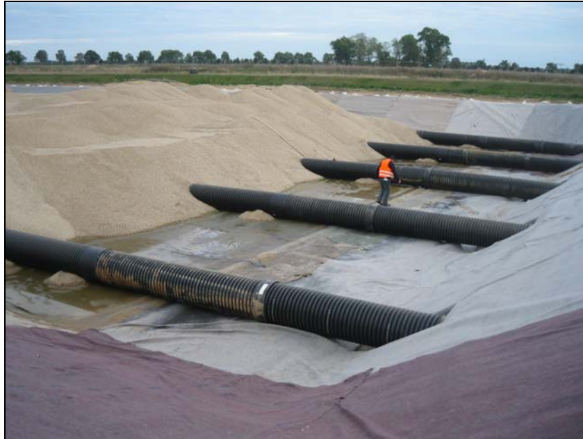
Abb. 2: Zentrale Bodenfilter mit Dränrohren
