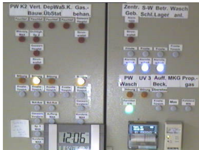
Abb. 3: Schalttafel nach der Alarmauslösung
