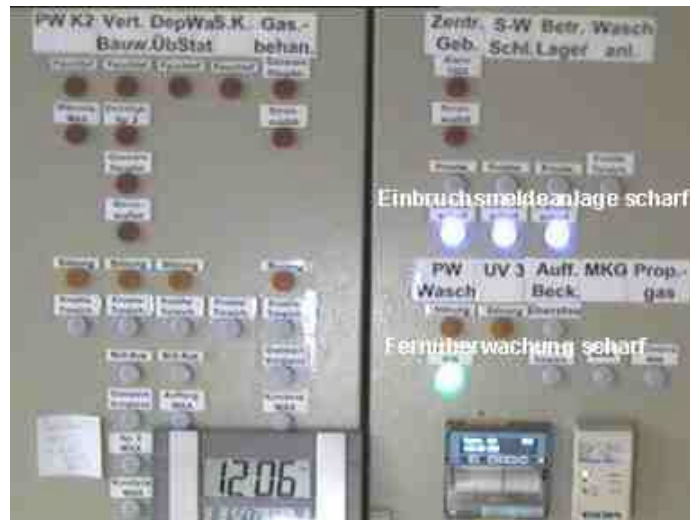
Abb. 2: Schalttafel vor der Alarmauslösung
